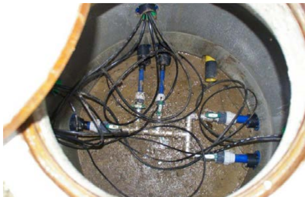
Einer von mehreren Kontrollschächten: Wasser-, Strom- und Datenleitungen
