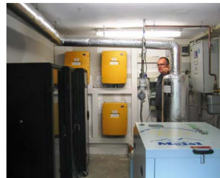
Energiezentrale der Tutzinger Hütte: Links die Schränke mit den Lithium-Batterien, rechts vorne das Blockheizkraftwerk, hinten Elektriker Benedikt Geiger
